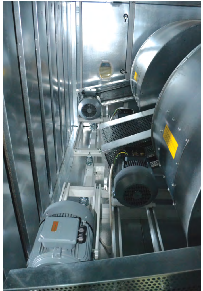
Dual fan and run & standby motor
