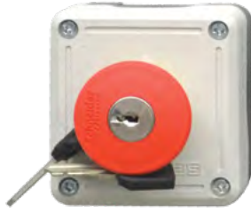
Fan emergency stop button
